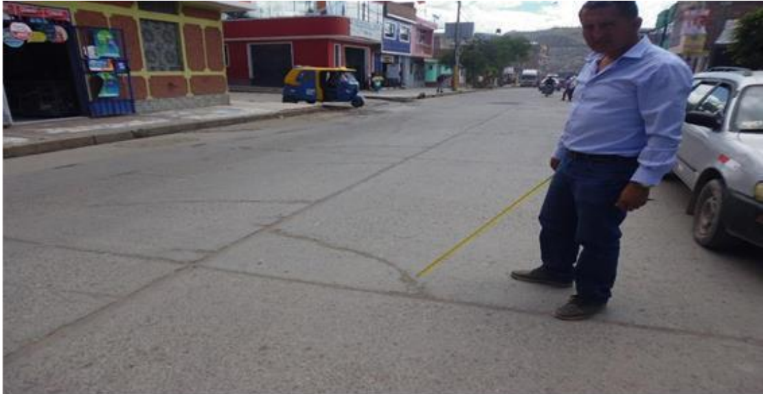
IMAGEN 19: SE OBSERVA UNA GRIETA DE ESQUINA Y TAMBIÉN SE OBSERVA PULIMIENTO DE AGREGADO.
