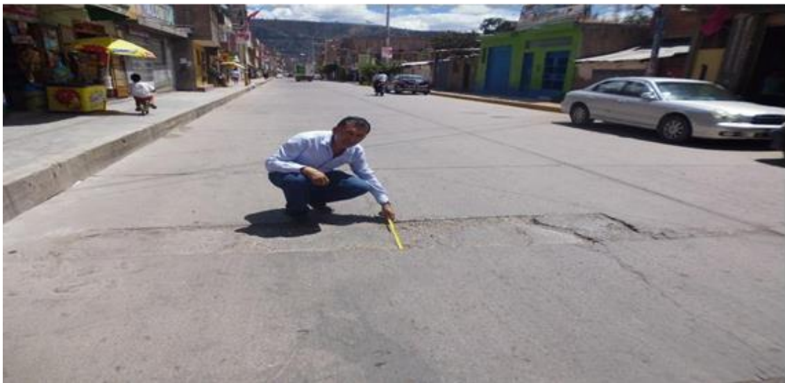
IMAGEN 20: SE OBSERVA PARCHE GRANDE CON UNA SEVERIDAD ALTA
