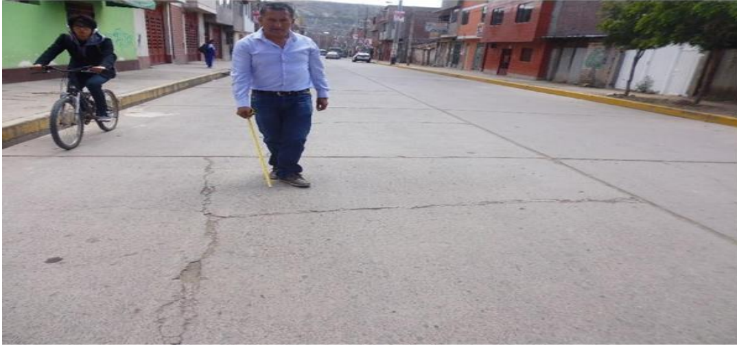
IMAGEN 21: SE OBSERVA PULIMENTO DE AGREGADO, GRIETA LONGITUDINAL Y GRIETA TRANSVERSAL
