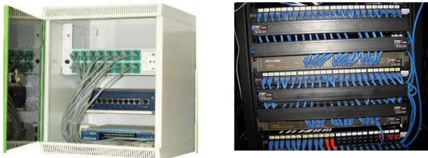
Fuente: Cableado horizontal (15).
