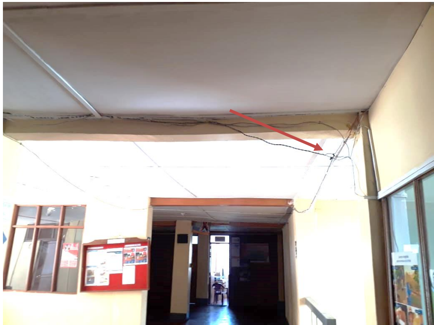
Gráfico Nro.18. Diagnóstico del cableado actual.
