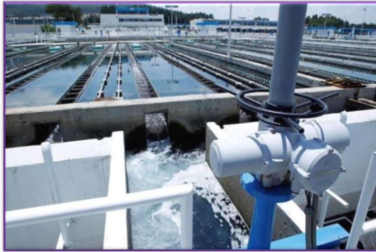
Imagen 03: Planta de tratamiento de agua potable
