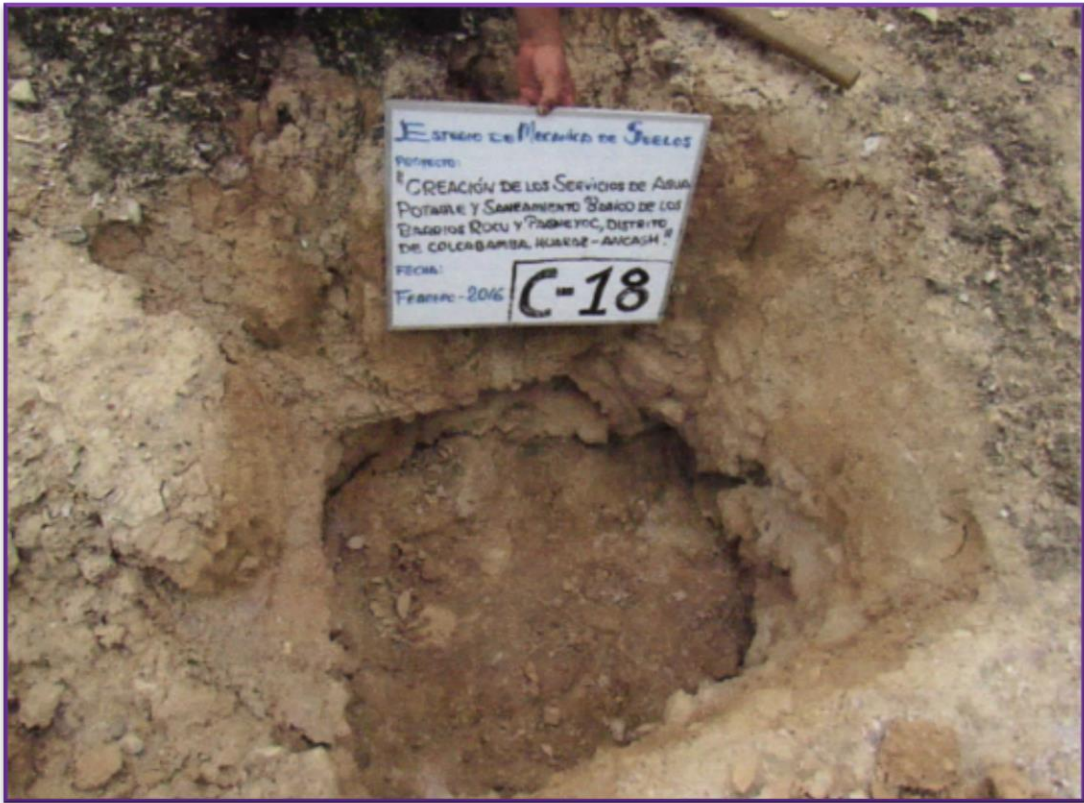
Fotografía 09: Se puede apreciar la exploración de calicata a cielo abierto en donde será proyectado el reservorio del sector Paqueyoc.
