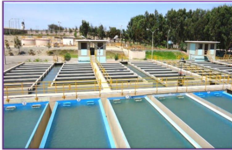
Imagen 02: Tratamiento de agua potable
