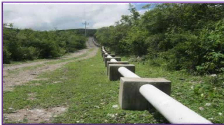
Imagen 12: Tubería en línea de conducción.
