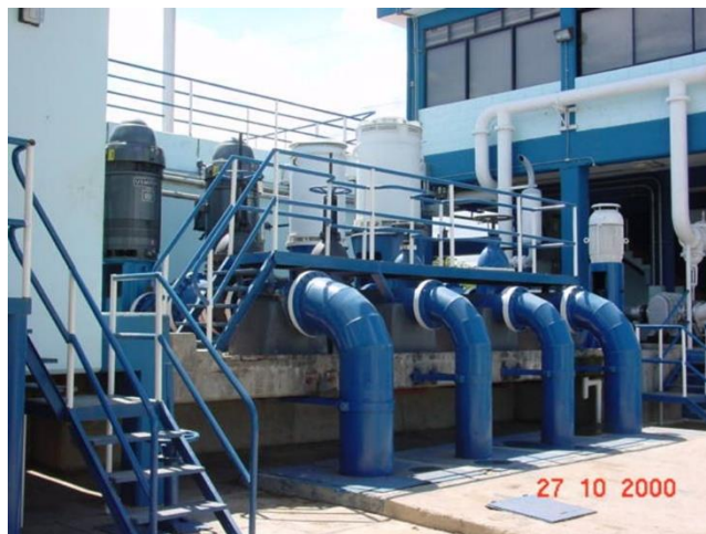
Fuente: Caseta de bombeo de la PTAP/Hidráulica Norte
