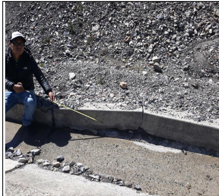
Fotografía N° 08: vista de la patología de fracturamiento.
