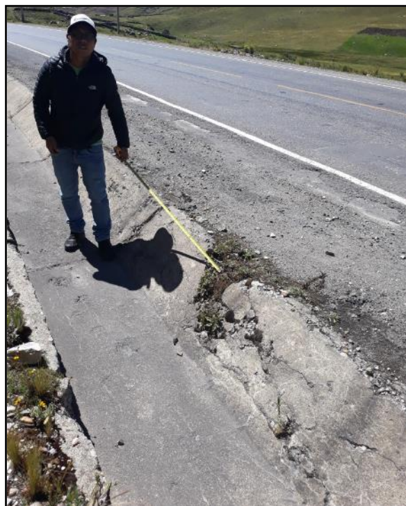
Fotografía N° 15: vista de la patología grieta en el margen derecho de la cuneta.
