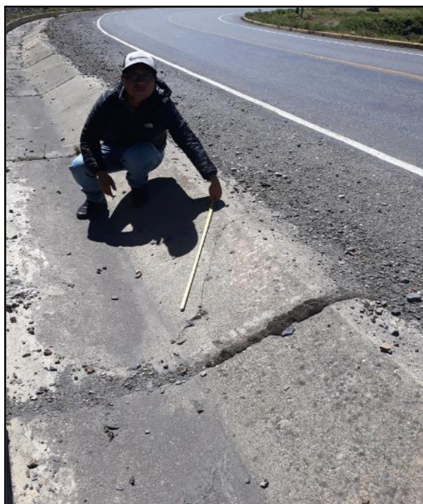
Fotografía N° 13: vista de la patología fisuras en el margen derecho de la cuneta.
