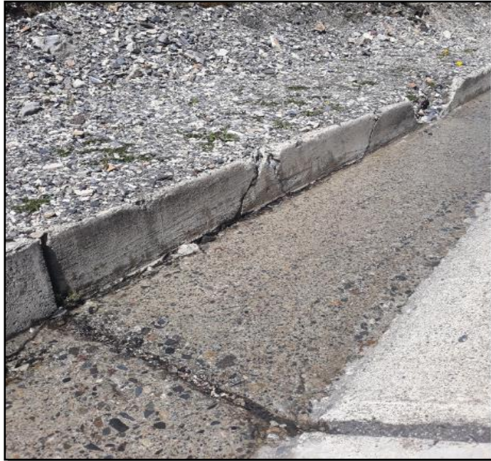
Fotografía N° 09: vista de la patología de fracturamiento.
