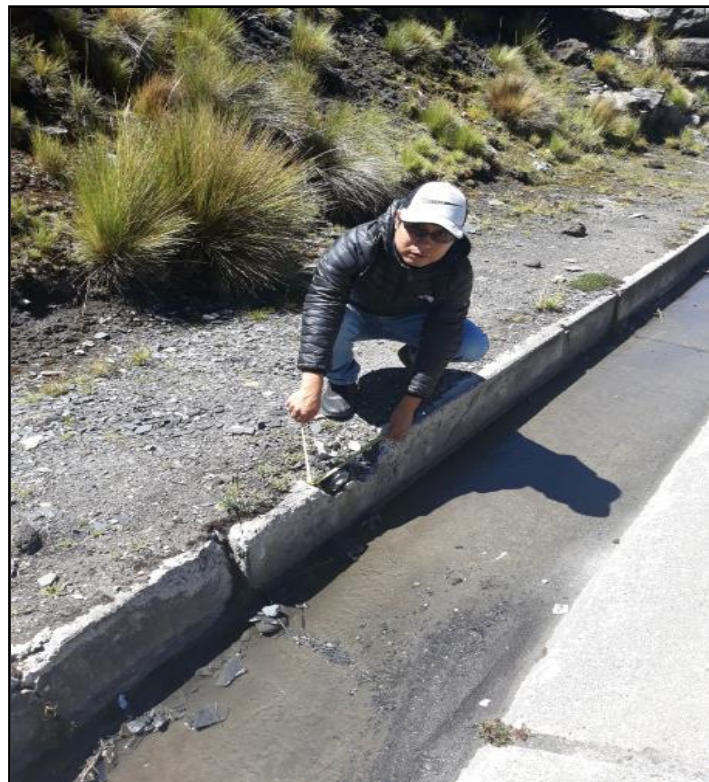
Fotografía N° 06: vista de la patología de fracturamiento.
