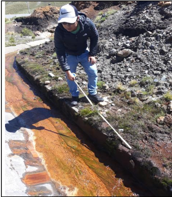
Fotografía N° 16: vista de musgo en el margen izquierdo de la cuneta.
