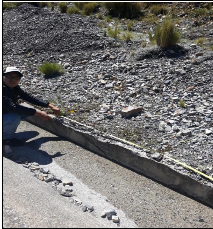
Fotografía N° 07: vista de la patología de fracturamiento.
