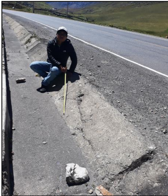
Fotografía N° 14: vista de la patología grieta en el margen derecho de la cuneta.
