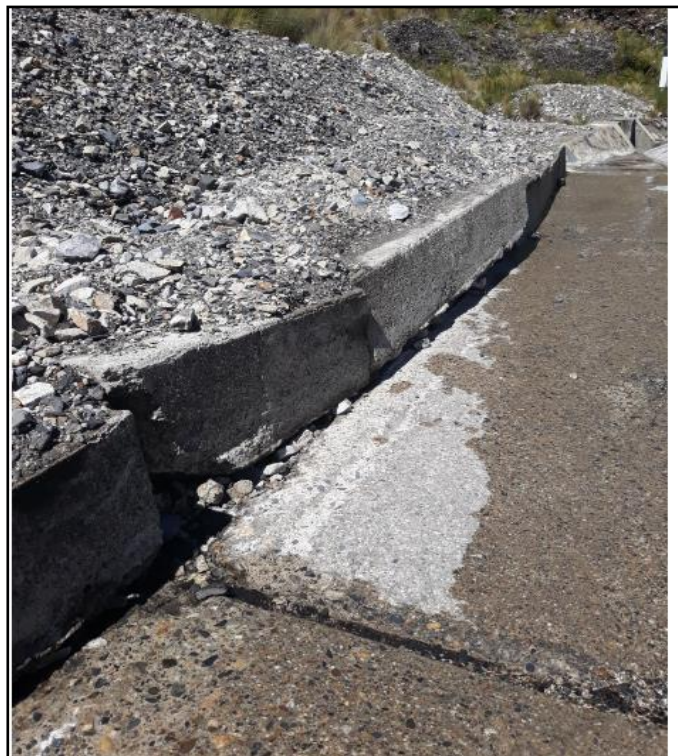
Fotografía N° 09: vista de la patología de fracturamiento en el margen izquierdo y desgaste del concreto en el piso (erosión).
