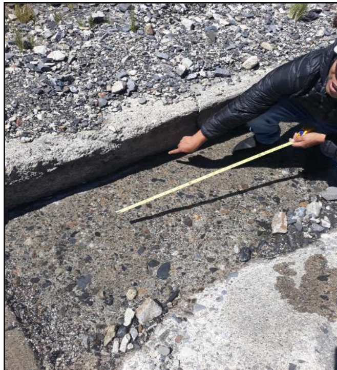
Fotografía N° 11: vista del desgaste del concreto en el piso (erosión).
