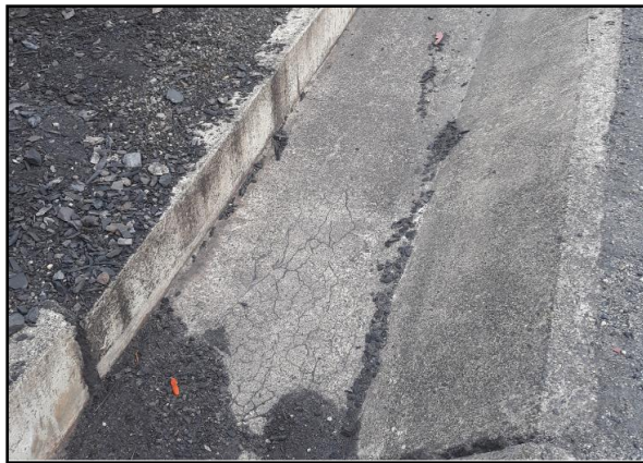
Fotografía N° 17: vista de fisuras en el piso de la cuneta.
