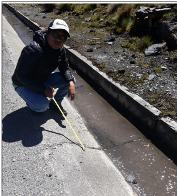
Fotografía N° 12: vista de la patología fisuras en el margen derecho de la cuneta.
