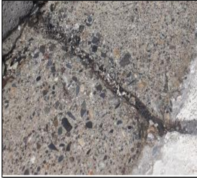
Fotografía N° 10: vista del desgaste del concreto en el piso (erosión).
