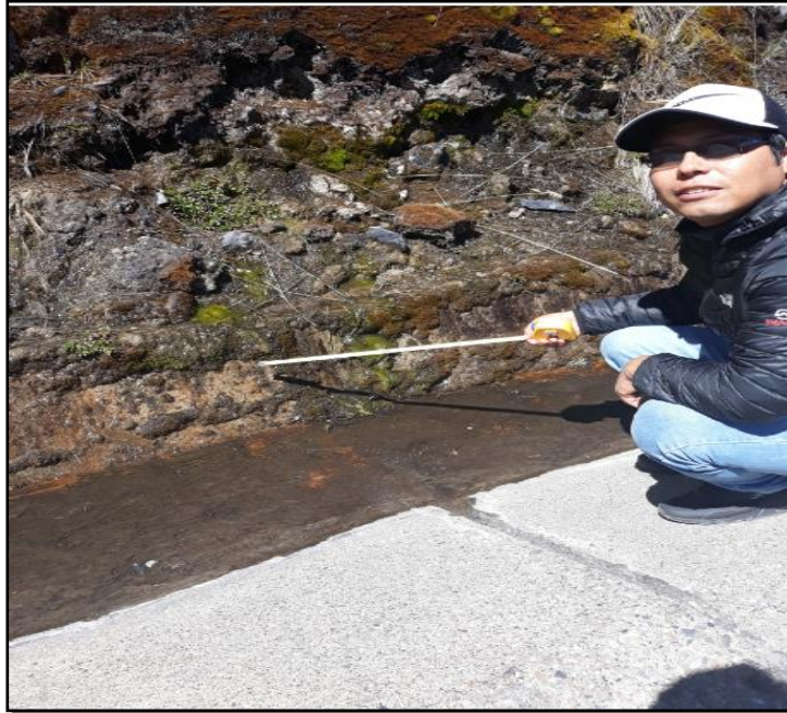
Fotografía N° 05: vista de musgo en el margen izquierdo de la cuneta.
