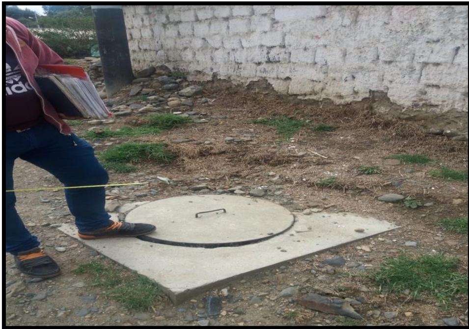
Imagen 08: Buzón de la red de desagüe. Fuente: Elaboración propio.
