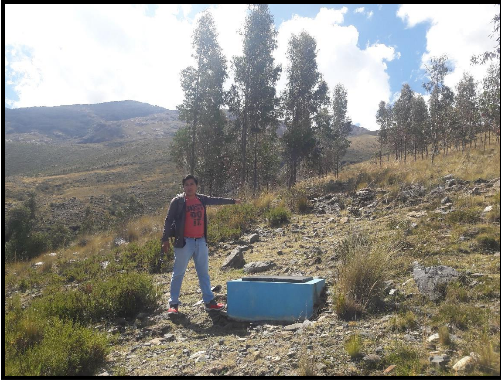
Imagen 06: Cámara rompe presión CRP tipo 6. Fuente: Elaboración propio.
