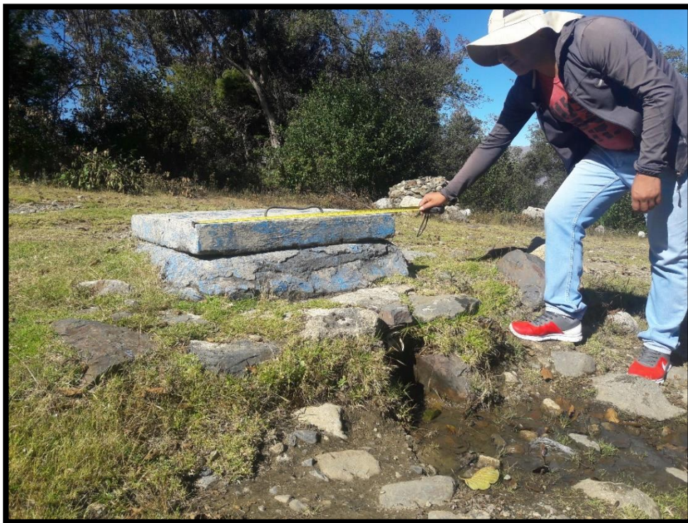
Imagen 05: Válvula de Purga. Fuente: Elaboración propio.
