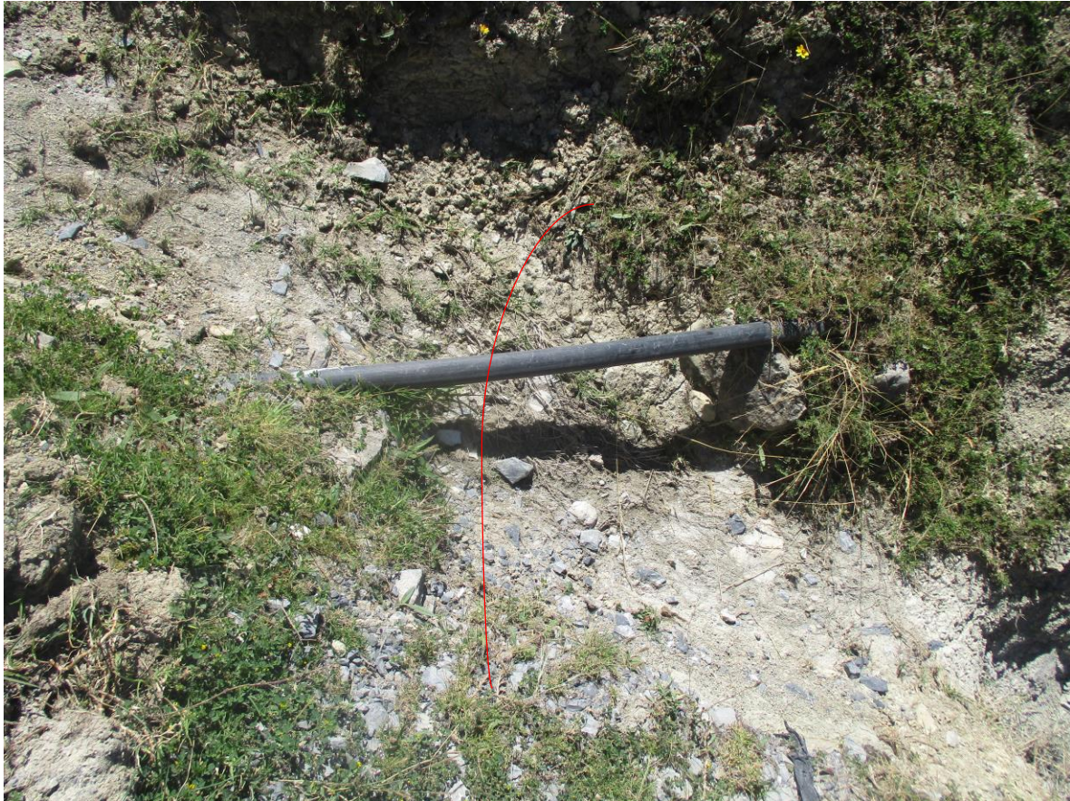
Imagen 6. Línea de aducción
