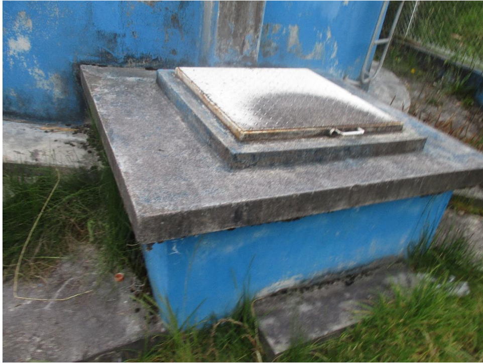
Fotografía N° 03: Caseta de válvulas del reservorio circular de la Localidad de Pichiu Centro.
