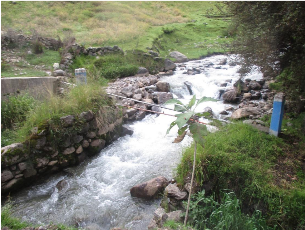
Fotografía N° 04: Cruce aéreo de la línea de conducción, la cual necesita ser reemplazada.
