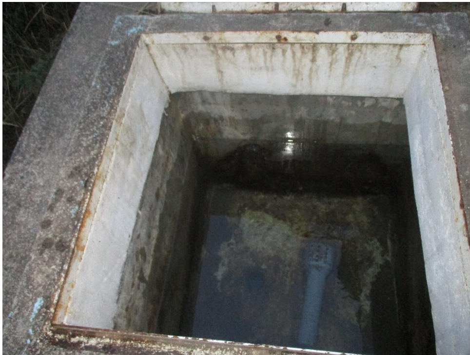
Fotografía N° 06: En la fotografía se observa la captación Monerpuquio.
