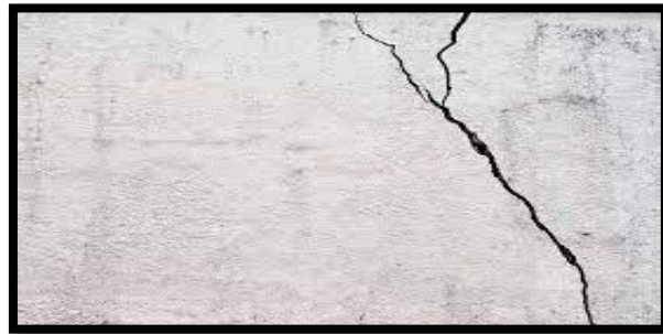
Figura 06: Fotografía De Grieta .
