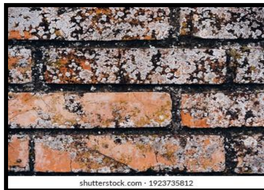
Figura 07: Fotografía De Eflorescencia .
