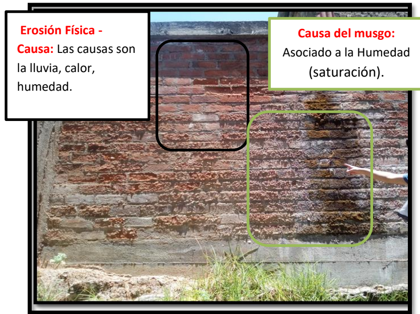
Imagen 1. Patología de musgo
