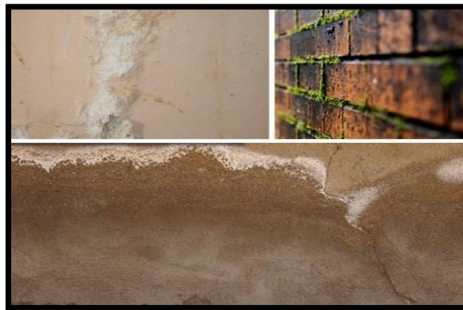
Figura 09: "Fotografía De Desprendimiento".
