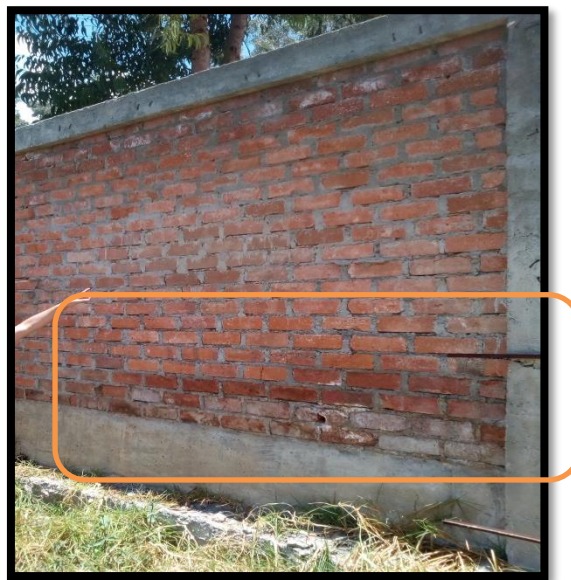
Imagen 4. Patología de Humedad
