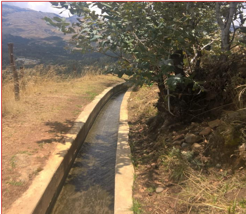
Foto N° 6: Presencia de vegetación cerca al canal de regadío
