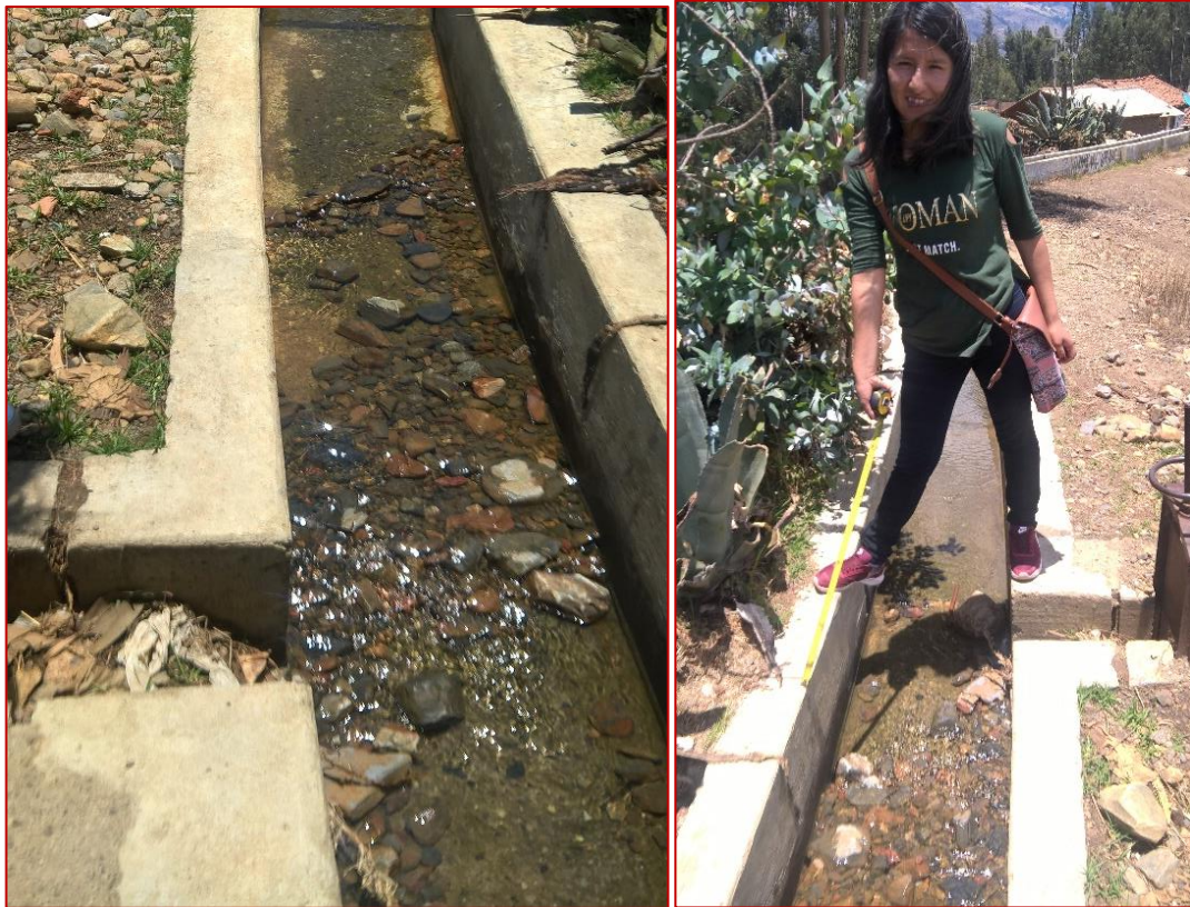
Foto N° 7: Tramo del canal sin mantenimiento
