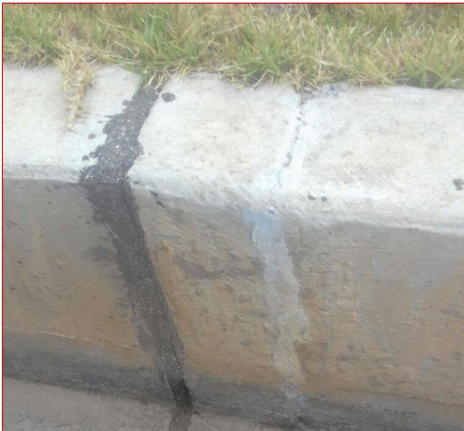
Foto N° 4: Agrietamiento de la sección del canal
