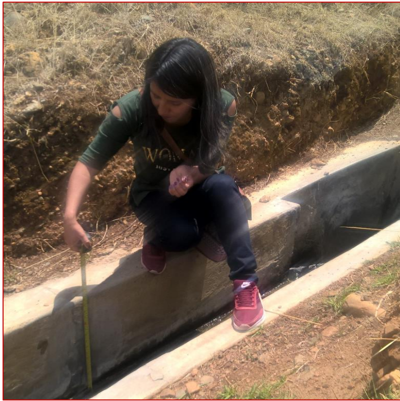
Foto N° 5: Identificación de una grieta en el canal
