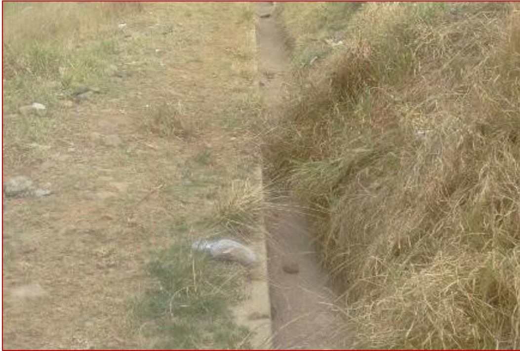
Foto N° 3: Presencia de vegetación cerca al canal de regadío
