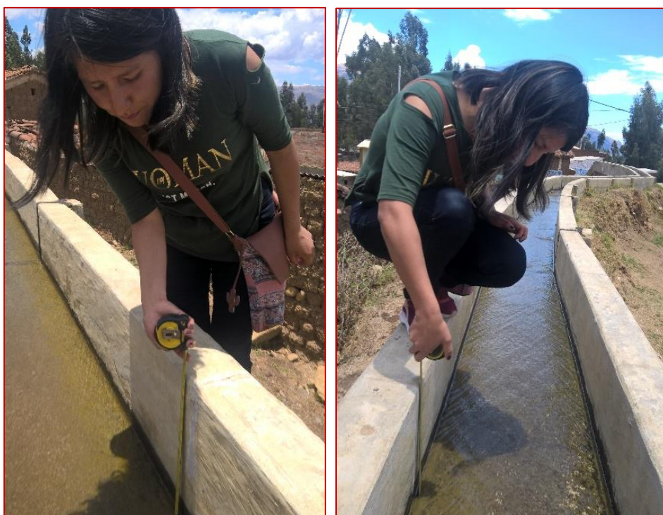
Foto N° 2: Medición de la patología encontrada
