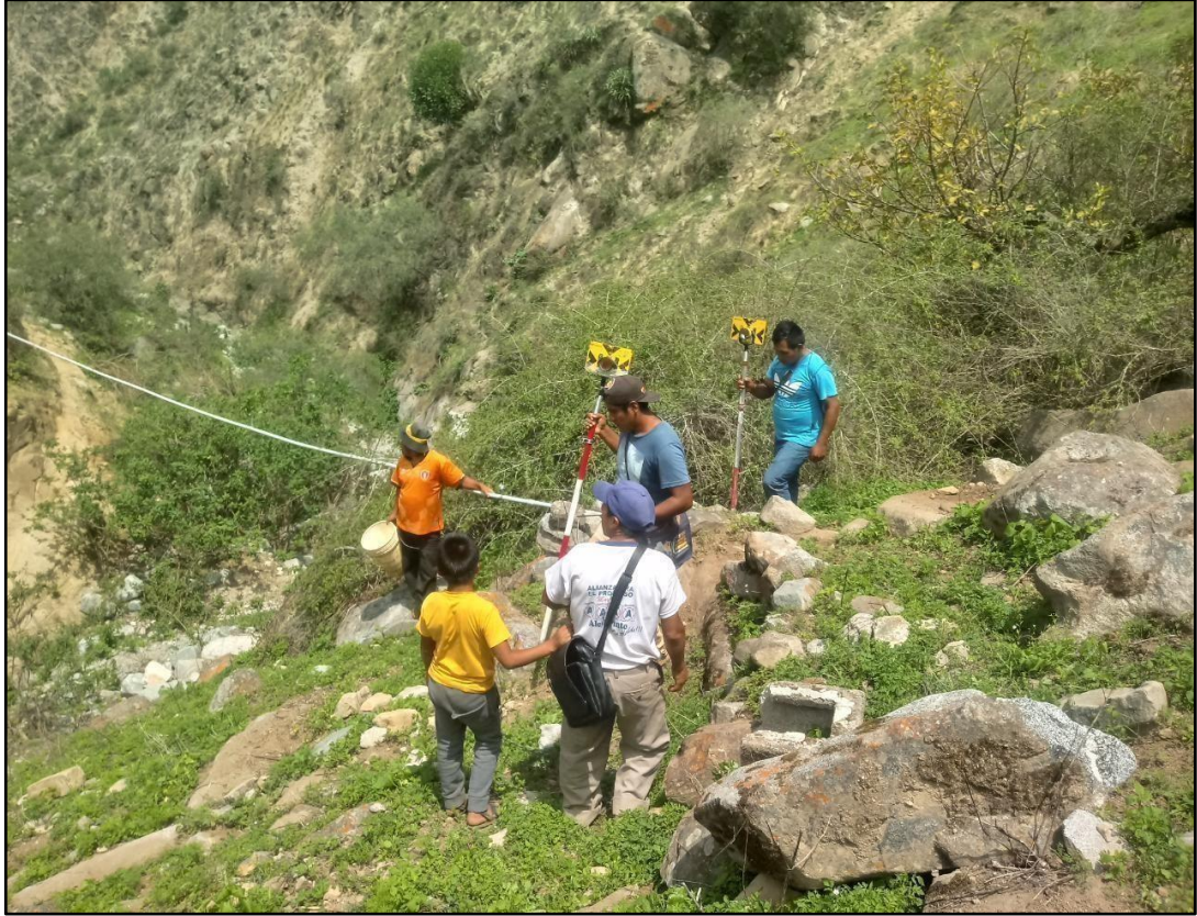
Imagen 3: Línea de conducción existente
