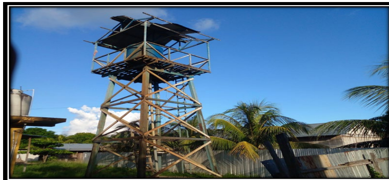
Imagen 02: En la imagen se aprecia el sistema de abastecimiento existente que presenta deterioro debido al tiempo de uso.
