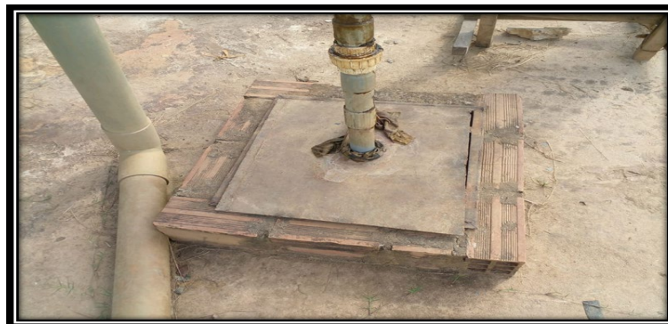
Imagen 03: Se aprecia la captación del actual sistema de abastecimiento el cual presenta fallas en su funcionamiento.
