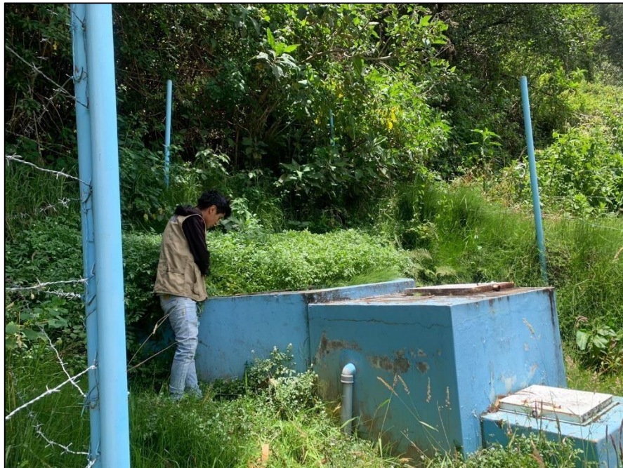
Imagen 2: Se puede observar la cámara de captación que se encuentra a una altitud de 2986.9 m.s.n.m
