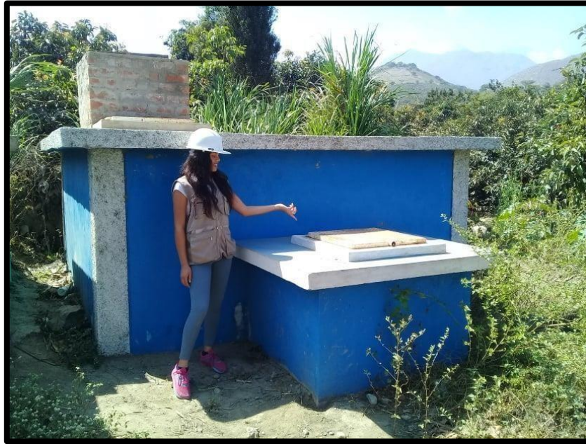
Imagen Nª 05: Reservorio almacenamiento del sistema de abastecimiento, del caserío de Larea Baja, distrito de Moro, provincia de Santa, región Áncash.
