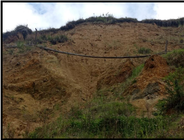
Fotografía 4: Línea de conducción, pase aéreo.
