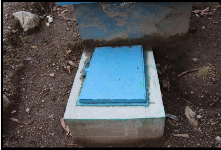
Fotografía 3: cámara rompe presión tipo 6 (CRP-6)
