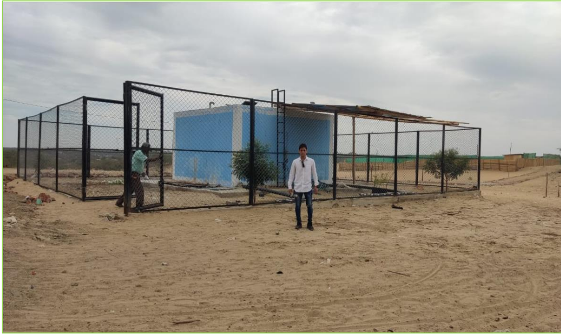
Fotografía 06: Pilón o tanque #2 de almacenamiento existentes para abastecer a población momentáneamente por la falta de un sistema de abastecimiento de agua potable.
