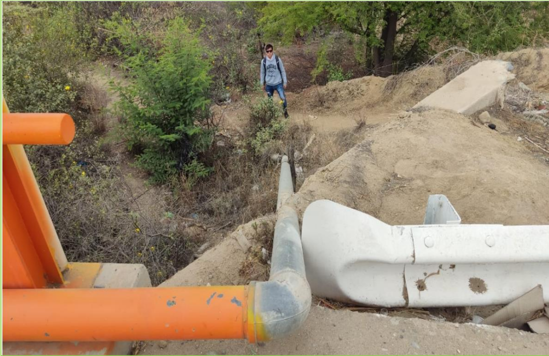
Fotografía 05: Verificación de Línea de conducción existente de 10" de F°G° para abastecimiento en donde se realizará el
