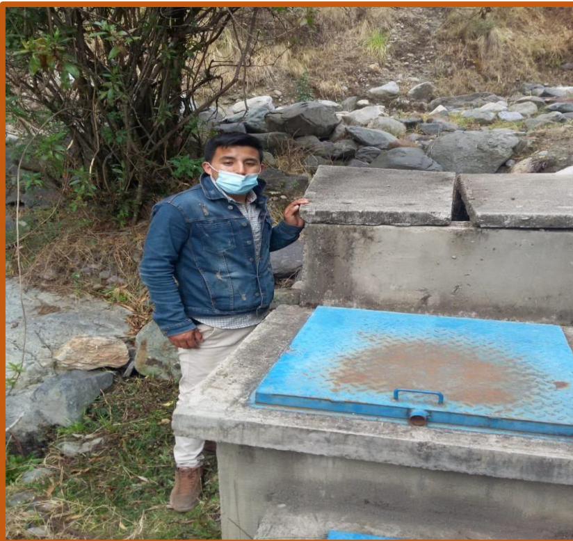
Fotografía 02: caja de distribución
