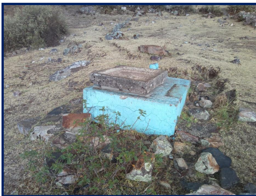
Imagen N° 9. Cámara rompe presión en la línea de conducción.
