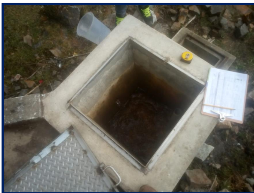
Imagen N° 1. Captación del centro poblado de Uchuhayta
