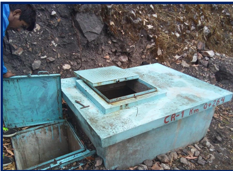
Imagen N° 12. Estructura de la cámara rompe presión entre el tramo 2 -3 de la línea de aducción.
