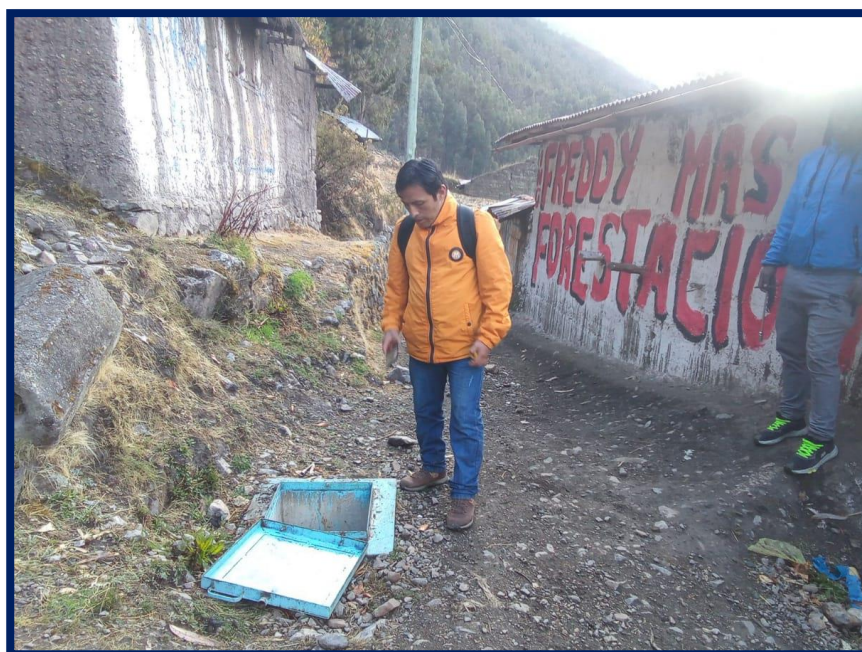
Imagen N° 6. Cámara de válvulas de la red de distribución, válvula n° 1.
