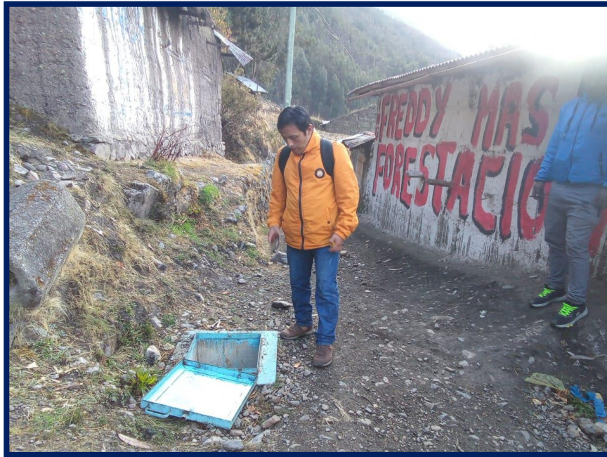
Imagen N° 13. Cámara de válvulas de la red de distribución, válvula n° 1.
