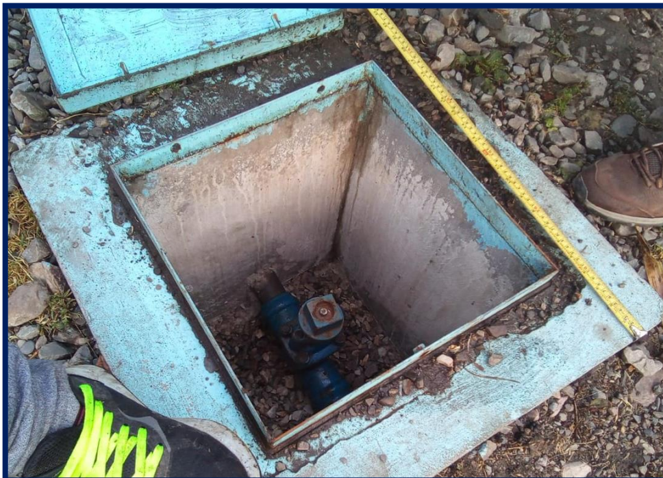
Imagen N° 14. Válvula de la red de distribución, válvula n° 2.
