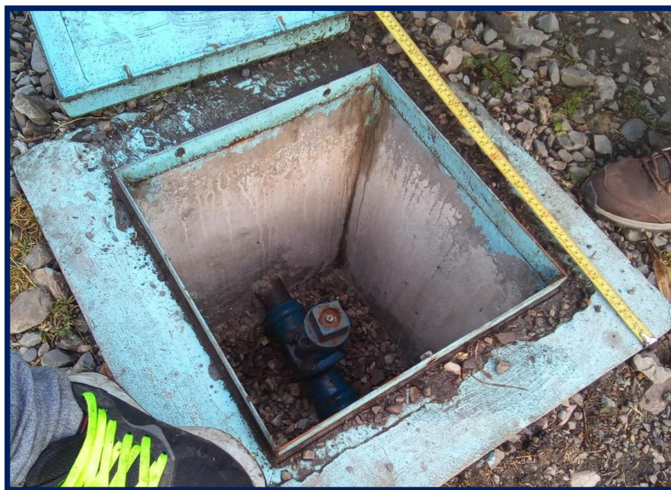
Imagen N° 7. Válvula de la red de distribución, válvula n° 2.
