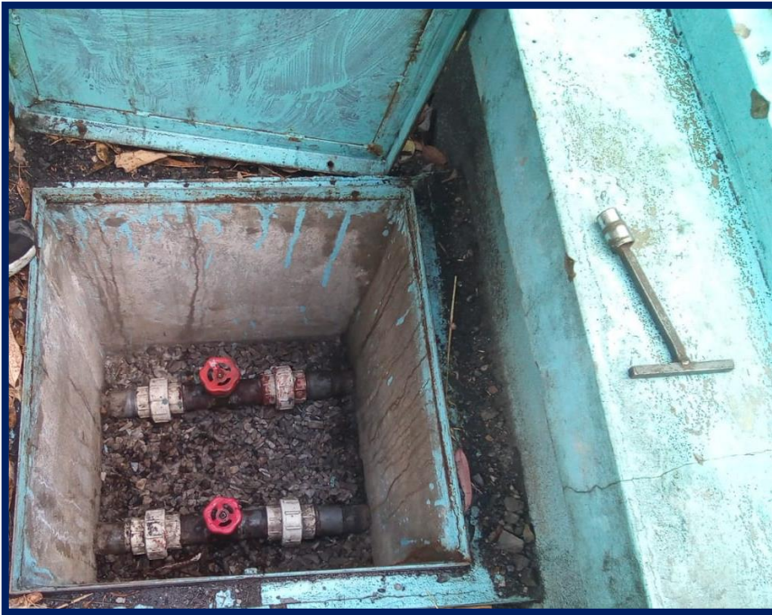
Imagen N° 11. Válvulas de control de la cámara rompe presión (CRP-7), en el tramo de la línea de aducción.
