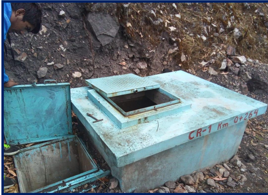
Imagen N° 5. Estructura de la cámara rompe presión entre el tramo 2 -3 de la línea de aducción.
