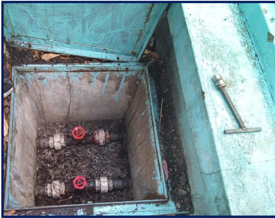
Imagen N° 4. Válvulas de control de la cámara rompe presión (CRP-7), en el tramo de la línea de aducción.
