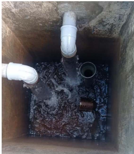
FOTO N° 10: CAMARA DE UNION SU ESTADO ACTUAL EN LA QUE SE ENCUENTRA
