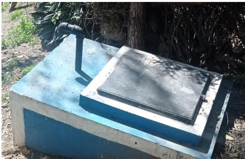
FOTO N° 21: SEGUNDA CAMARA ROMPE PRESION TIPO 7 SU ESTADO ACTUAL EN LA QUE SE ENCUENTRA
