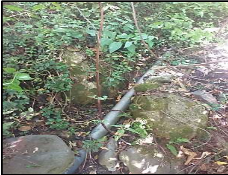
Foto N° 03: Línea de conducción es parte de la captación que permite conducir el agua hasta el reservorio, tiene una longitud aproximada de 600 ml.
