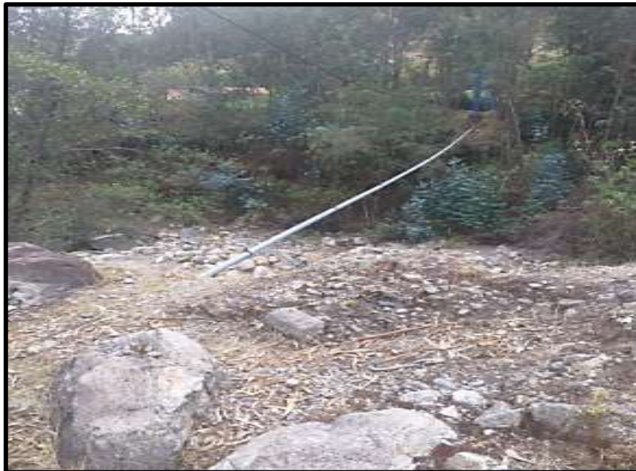
Foto N° 06: La tubería de la red de distribución se encuentra a la intemperie en 2 zonas, no cuenta con válvulas de purga, ni válvulas de control.
