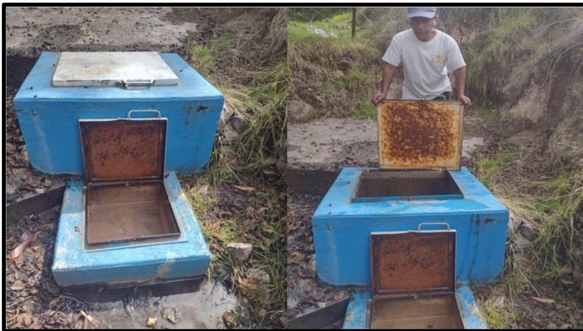
Fotografía N° 03. Evaluación de la captación exterior
