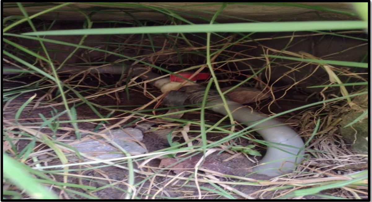
Fotografía N° 09. Válvulas simples que son utilizadas como cajas de registro
