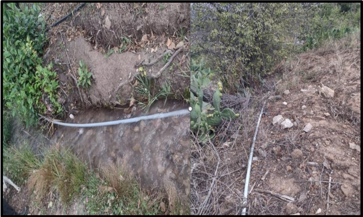
Fotografía N° 08. Tubos al intemperie-Línea de aducción y distribución
