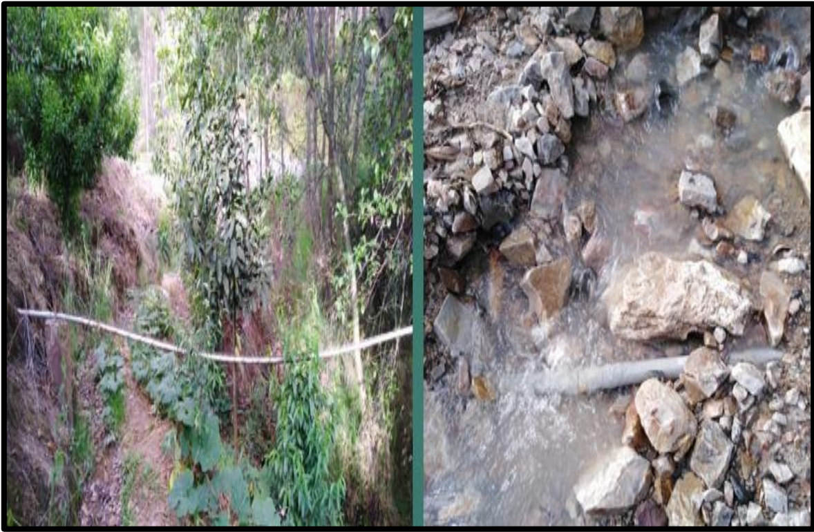
Fotografía N° 05. Tubos al intemperie-Línea de conducción
