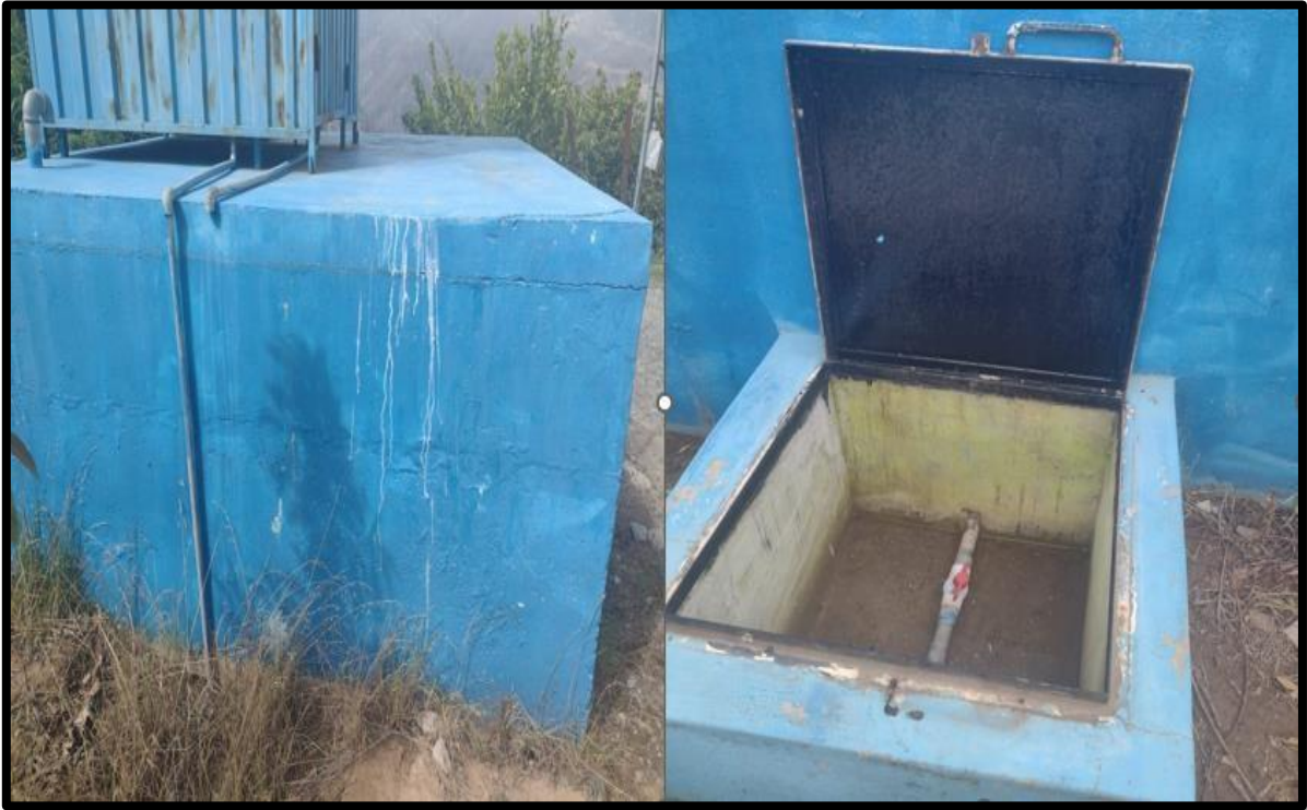
Fotografía N° 07. Patologías del concreto. fisuras y agrietamientos
