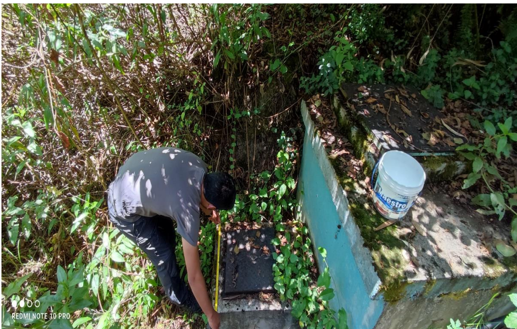
Figura 18: Captación del sistema de abastecimiento de agua potable del centro poblado de Mallas
