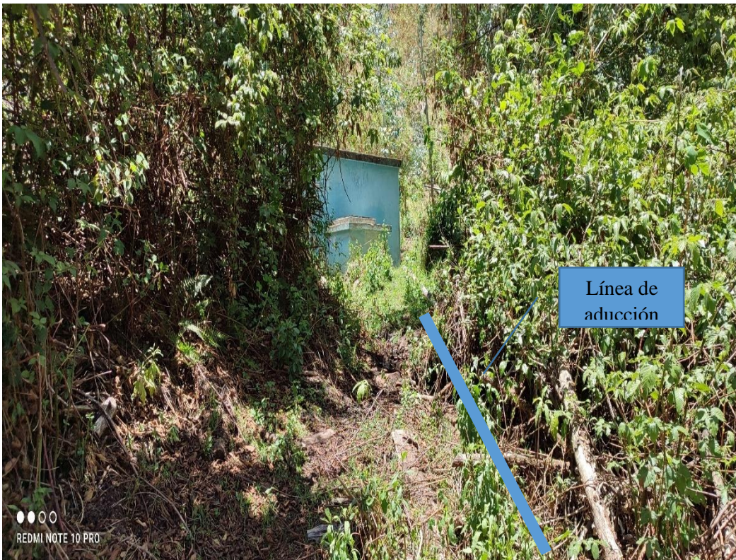
Figura 20: Línea de aducción del sistema de abastecimiento de agua potable del centro poblado de Mallas
