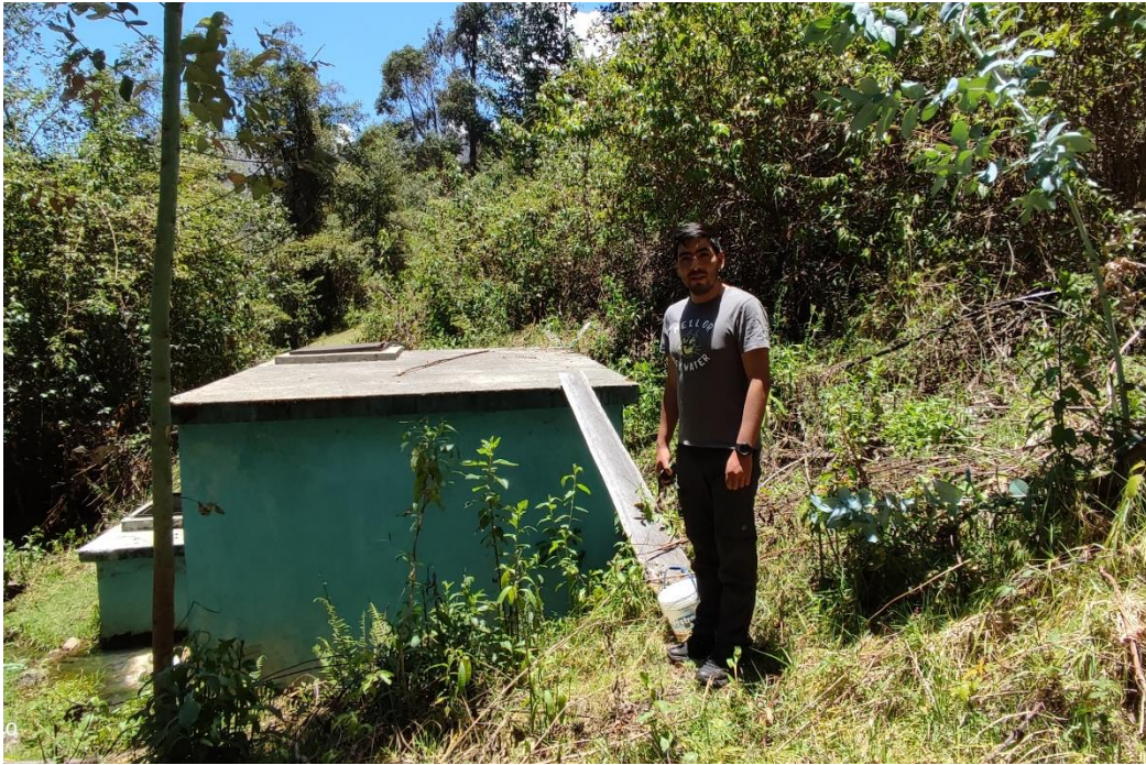
Figura 19: Reservorio del Sistema de abastecimiento de agua potable del centro poblado de Mallas
