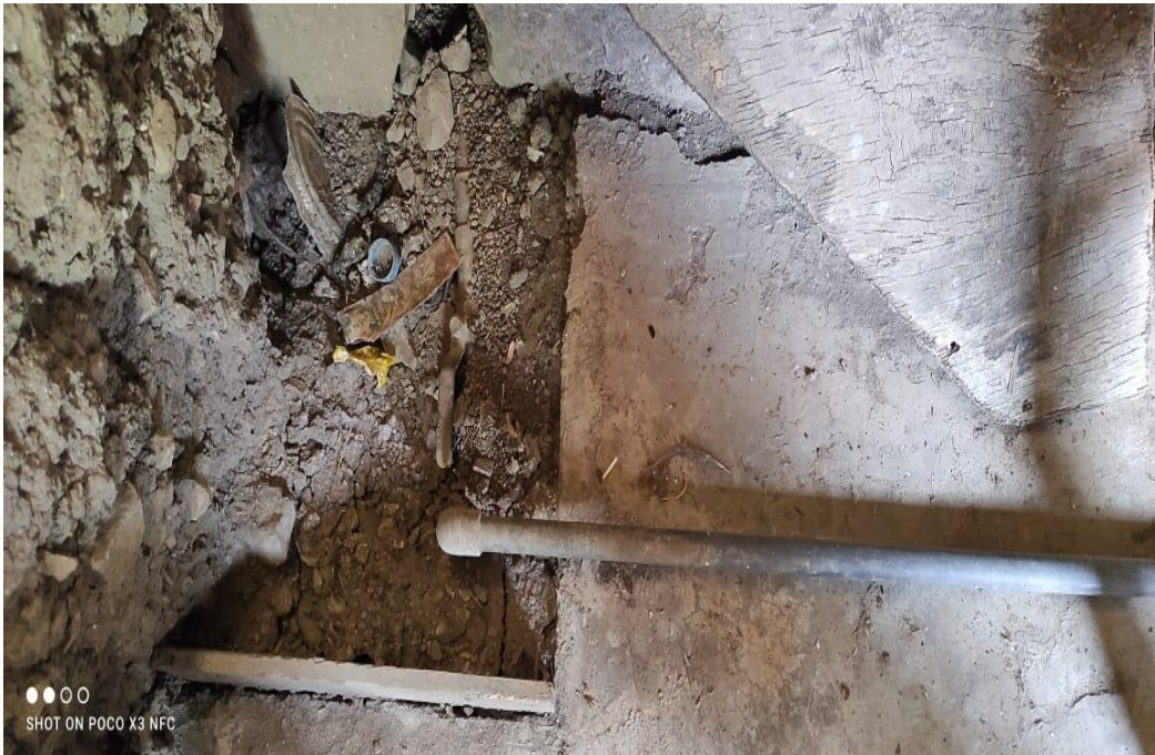
Figura 22: Conexiones domiciliarias del sistema de abastecimiento de agua potable del centro poblado de Mallas
