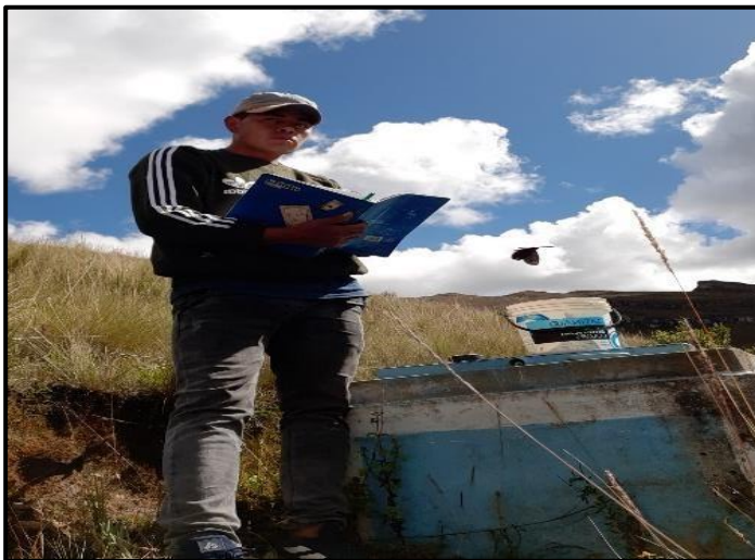
Figura 48: La primera CRP tipo 6; medición volumétrica del caudal
