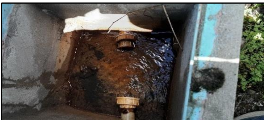
Figura 44: Cámara de válvulas de la captación n°1
