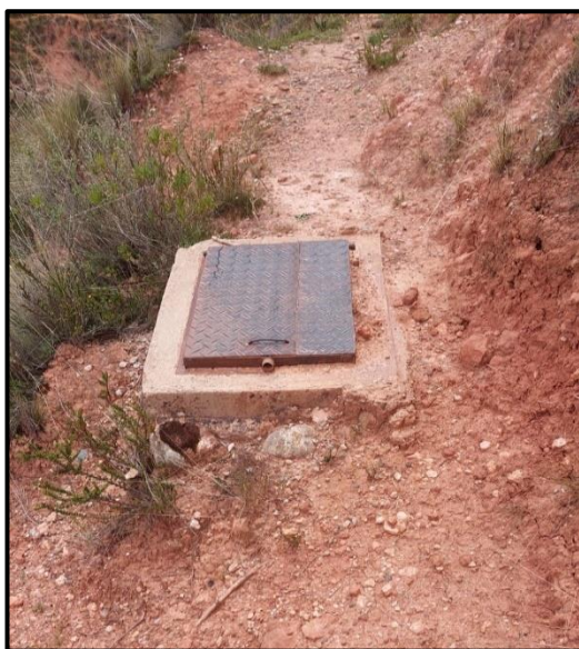
Figura 51: Cámara de válvula de aire
