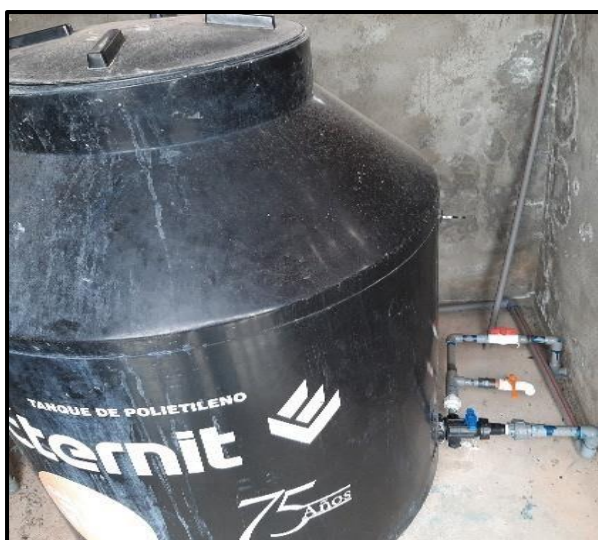
Figura 53: Sistema de cloración
