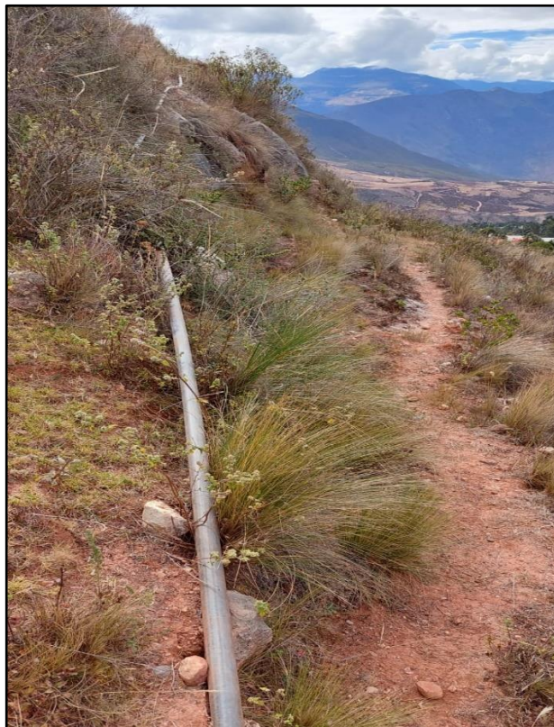
Figura 50: Tubo galvanizado de 2" en tramo accidentado
