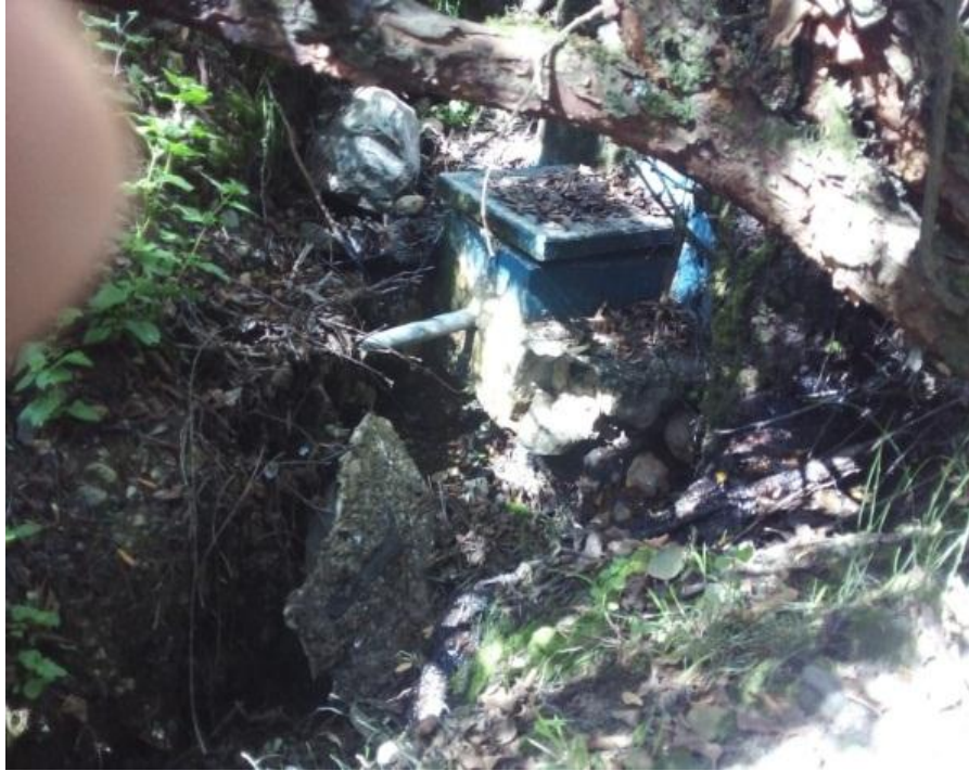
Fotografía 4. Cámara seca de la captación
