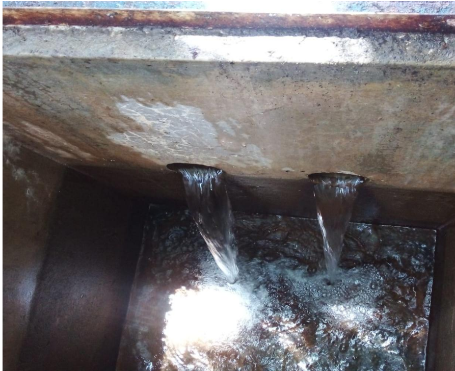
Fotografía 2. Llorones en la Captación Principal
