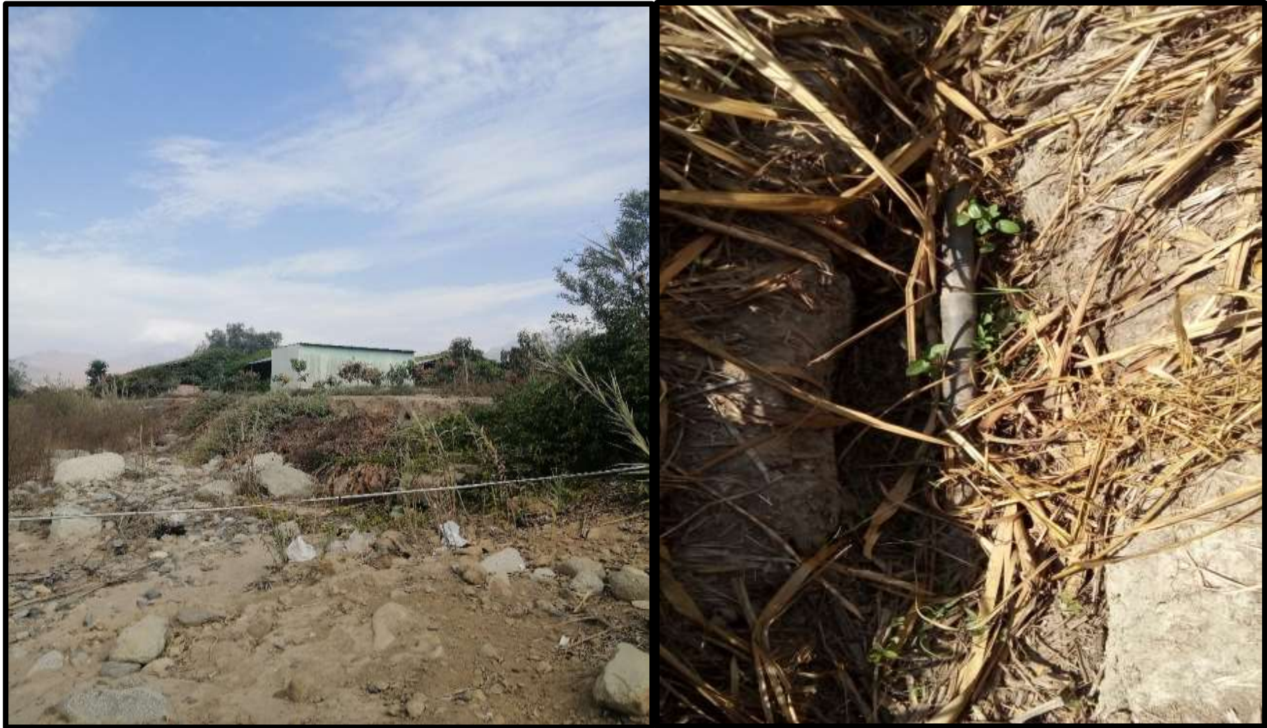
Imagen 22. Evaluación de la línea de conducción.
