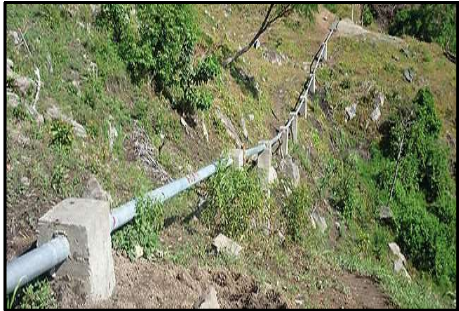
Imagen 12: Línea de Conducción
