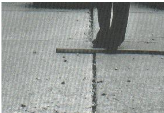
Figura 16. Escala de baja severidad.
