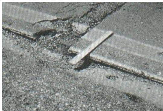
Figura 22. Desnivel carril / berma de baja severidad.
