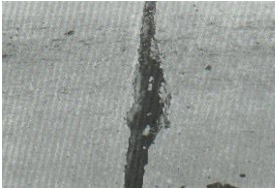
Figura 20. Daño del sello de junta de severidad media.
