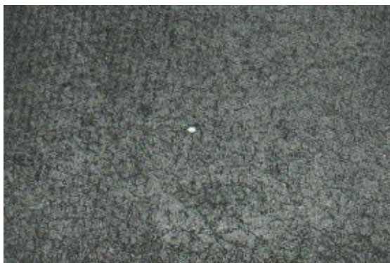
Figura 44. Desconchamiento / Mapa de grietas / Craquelado de baja severidad.
