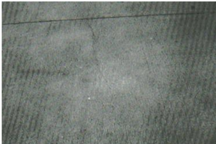
Figura 47. Grietas de contracción.
