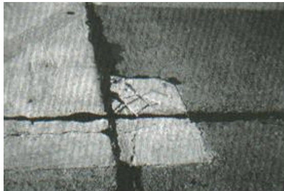
Figura 32. Parche pequeño de severidad media.
