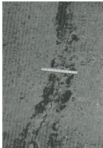
Figura 25. Grietas lineales de baja severidad en losa de concreto simple.
