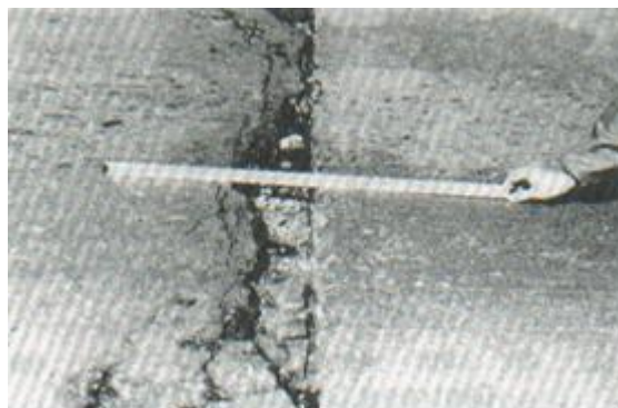
Figura 53. Descascaramiento de junta de alta severidad.
