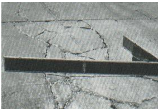
Figura 40. Punzonamiento de alta severidad.
