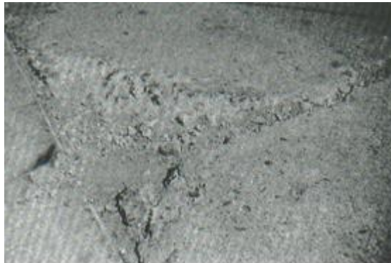
Figura 50. Descascaramiento de esquina de alta severidad.
