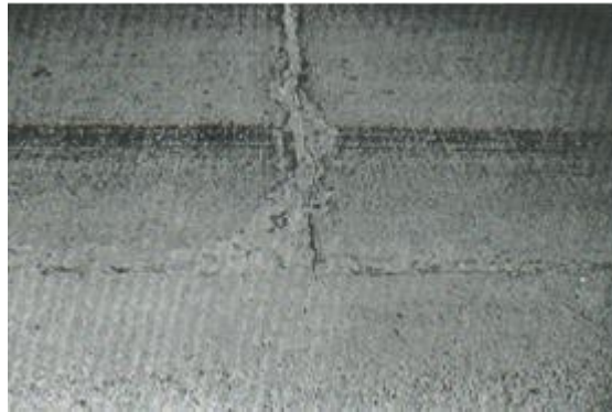
Figura 49. Descascaramiento de esquina de severidad media.
