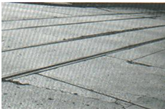
Figura 41. Cruce de vía férrea de baja severidad.
