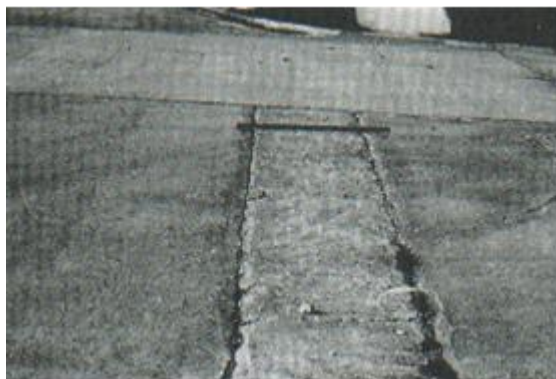
Figura 29. Parche grande y acometidas de servicios públicos de severidad media.
