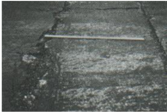
Figura 30. Parche grande y acometidas de servicios públicos de alta severidad.
