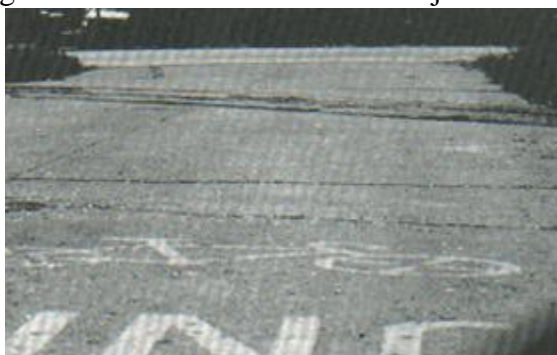
Figura 42. Cruce de vía férrea de severidad media.
