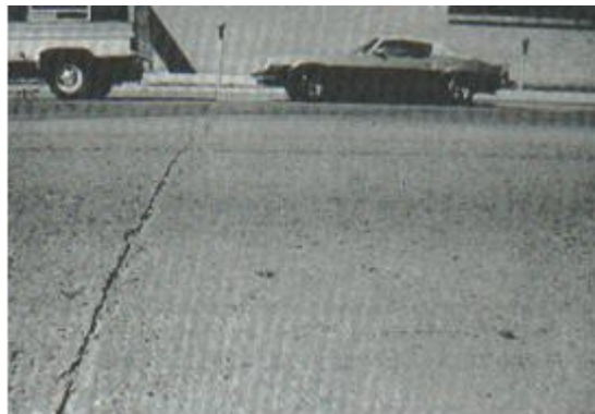
Figura 51. Descascaramiento de junta de baja severidad.
