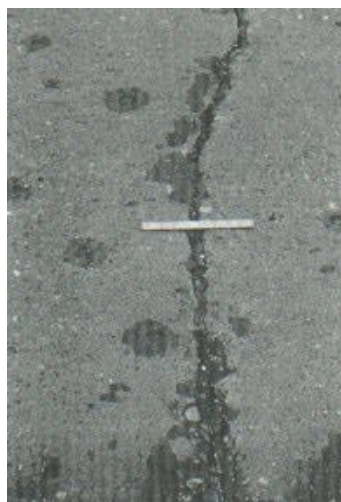
Figura 26. Grietas lineales de severidad media en losa de concreto reforzado.
