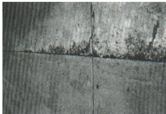
Figura 52. Descascaramiento de junta de severidad media.
