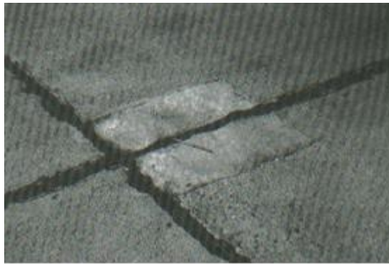
Figura 31. Parche pequeño de baja severidad
