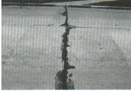
Figura 19. Daño del sello de junta de baja severidad.
