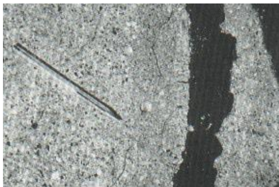
Figura 13. Grieta de durabilidad de baja severidad.
