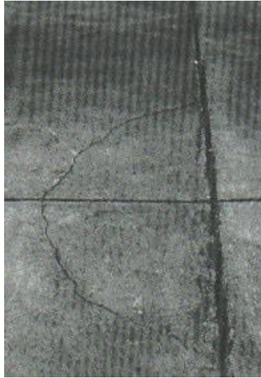
Figura 7. Grieta de esquina de baja severidad.
