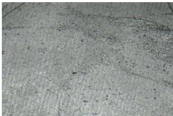
Figura 15. Grieta de durabilidad de alta severidad.
