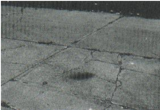
Figura 12. Losa dividida de alta severidad.
