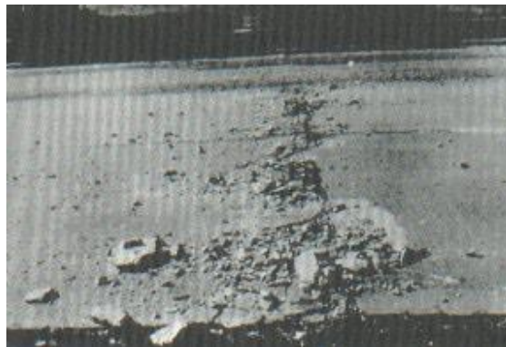
Figura 5. Blowup / Buckling de media severidad.
