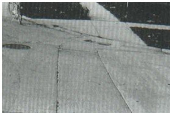
Figura 28. Parche grande y acometidas de servicios públicos de baja severidad.
