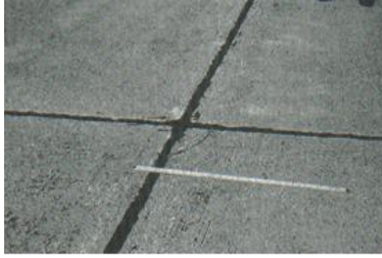
Figura 48. Descascaramiento de esquina de baja severidad.
