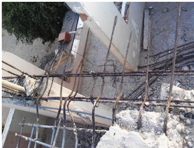
Gráfico 09: Oxidación en barras de acero
