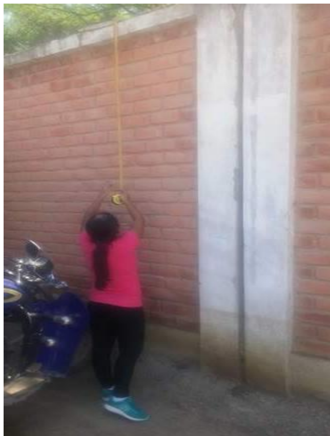
Gráfico 104: Presencia de delaminación en viga y humedad en sobrecimiento
