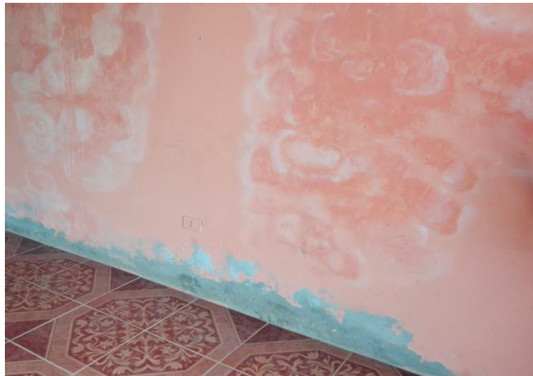
Gráfico03: Humedad en muro
