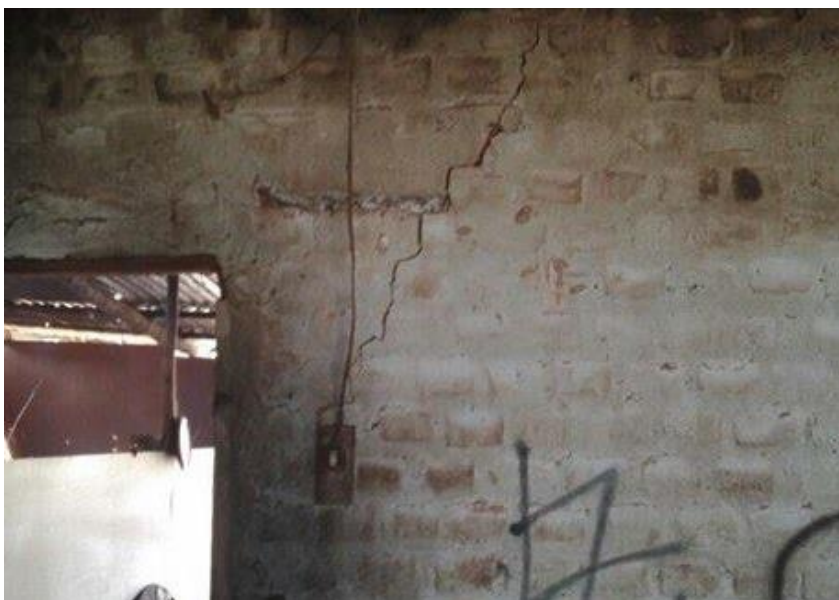
Gráfico 02: Grieta en muro de vivienda de albañilería confinada
