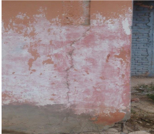
Gráfico 01: Fisura en muro de albañilería
