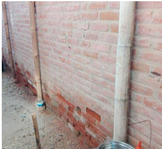
Gráfico 08: Erosión en muro de albañilería.
