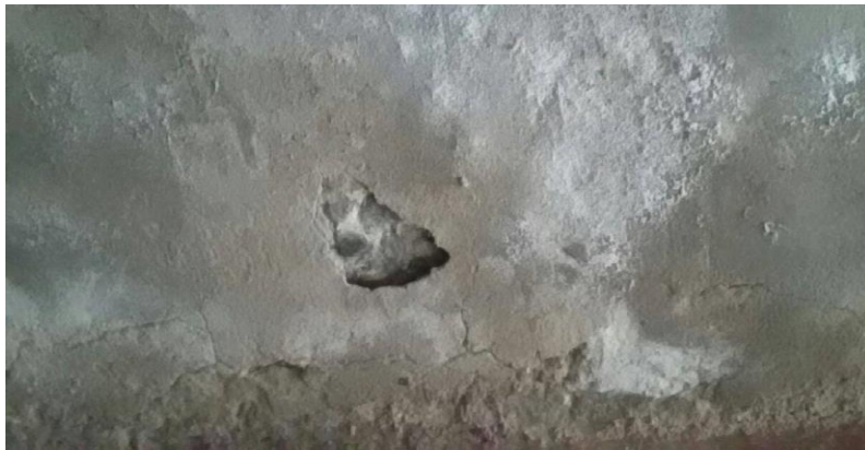
Gráfico 05: Delaminación en muro tarrajado.
