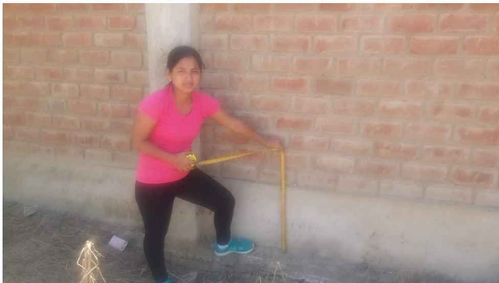
Gráfico 101: Presencia de fisura en sobrecimiento.
