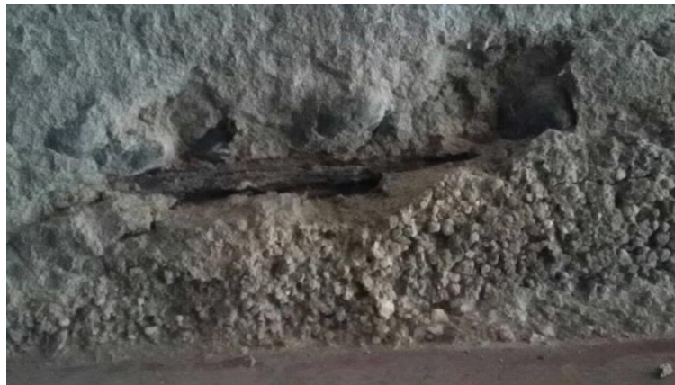
Gráfico 04: Corrosien en varilla de acero
