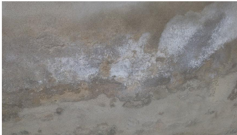
Gráfico 06: Eflorescencia en pared de vivienda
